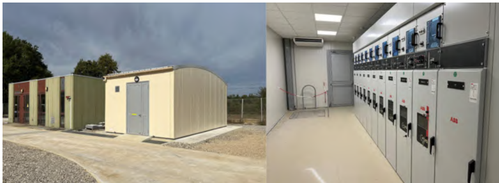
Nouveau bâtiment avec une demi-rame HTA
