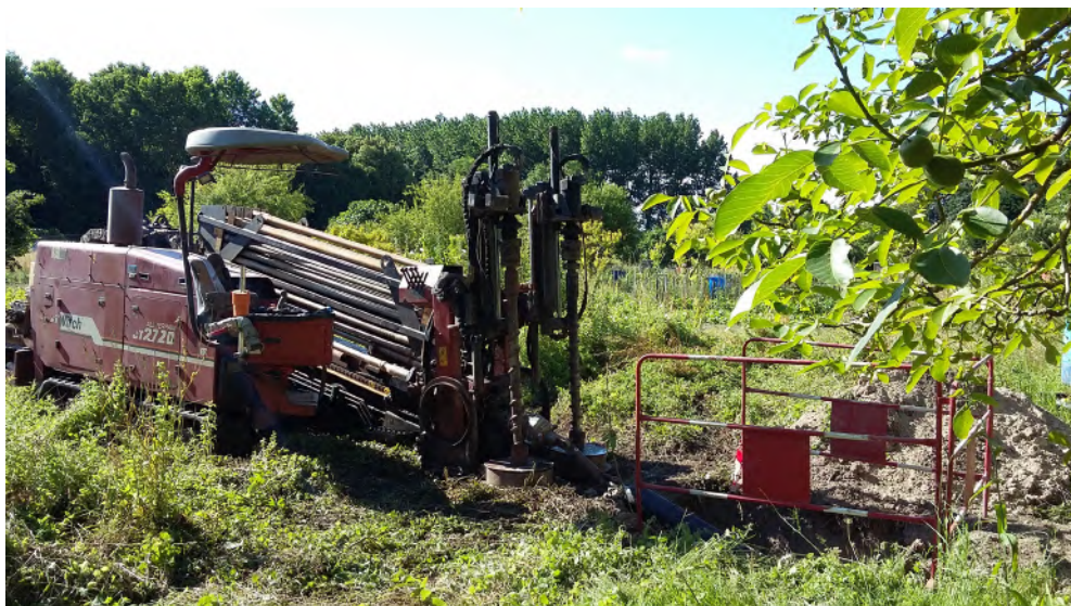
Utilisation du forage dirigé pour passer sous des voiries sans terrasser en traversée de route lors de travaux de renouvellement ou création en souterrain de ligne électrique 15 000 volts ou 20 000 volts.
