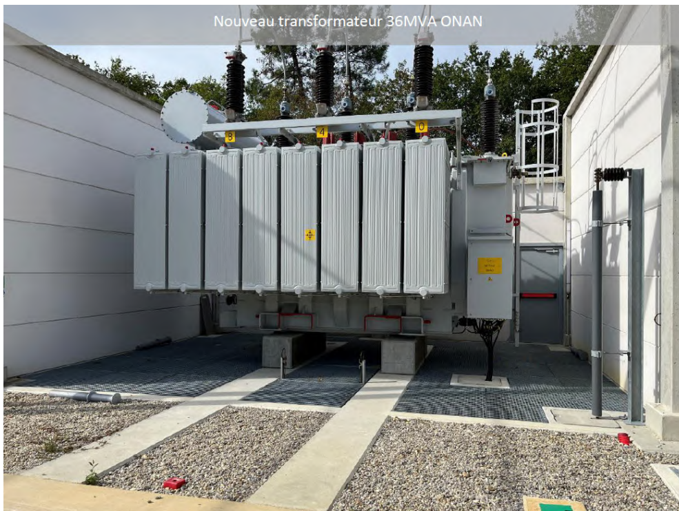
Nouveau transformateur 36MVA ONAN
